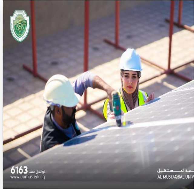
تم تركيب الألواح الشمسية على سطح البناية
